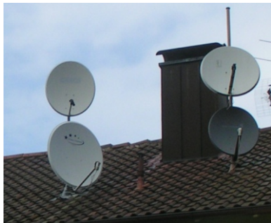
Bild 12: Beispiel für unzulässige technische Dachaufbauten
